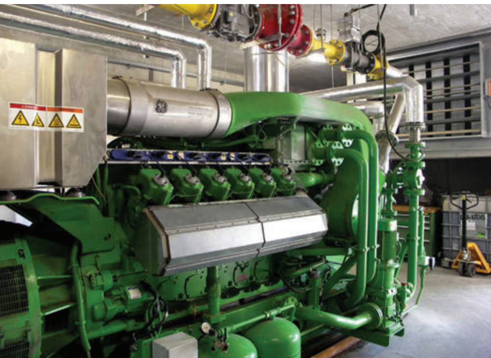
Turbina produkująca energię elektryczną, napędzana biogazem
