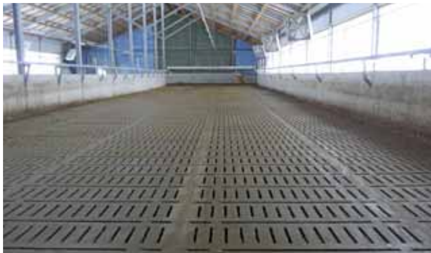
Fot. 6. Utrzymanie właściwego poziomu mikroklimatu nie byłoby możliwe bez urządzeń technicznych w budynku
