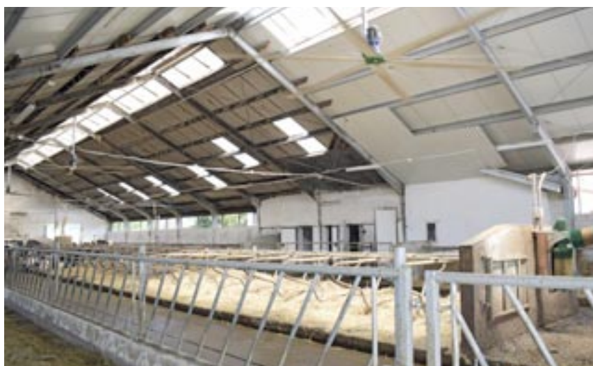
Fot. 5. Bez mieszaczy powietrza krowy wychodziły na zewnątrz budynku, szukały cienia; obecnie więcej czasu przebywają w środku budynku i nie zawsze chcą wychodzić
