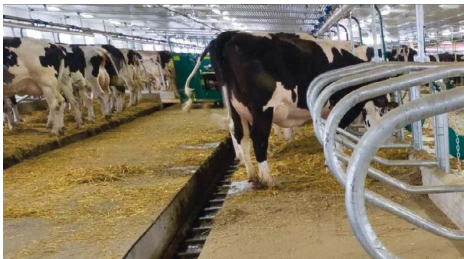
Fot. 2. System usuwania obornika firmy GEA do obór stanowiskowych
