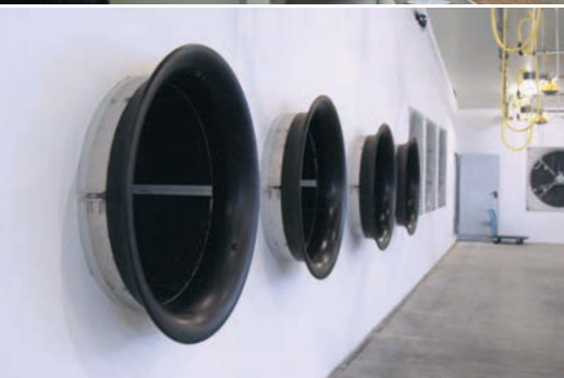
System Lavamatic MUTERS zdjęcie górne i środkowe część zewnątrzną, czerpnie wewnątrz kurnika zdjęcie dolne
