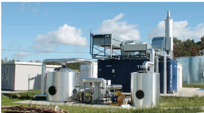
Fot. 2. Silnik kogeneracyjny w zabudowie kontenerowej oraz instalacja oczyszczania biogazu (źródło: Biowatt S.A.)
