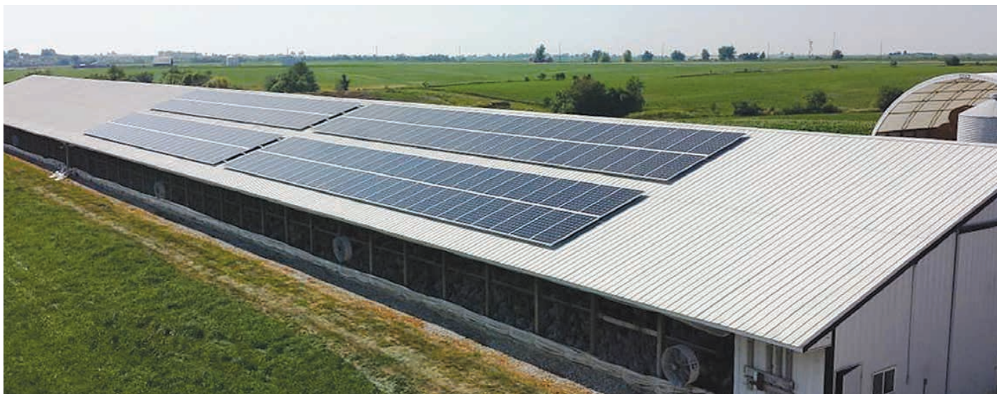
Rys. 4. Panele PV na dachu budynku inwentarskiego – źródło darmowej energii (fot. www.cbsolarinc.com )
